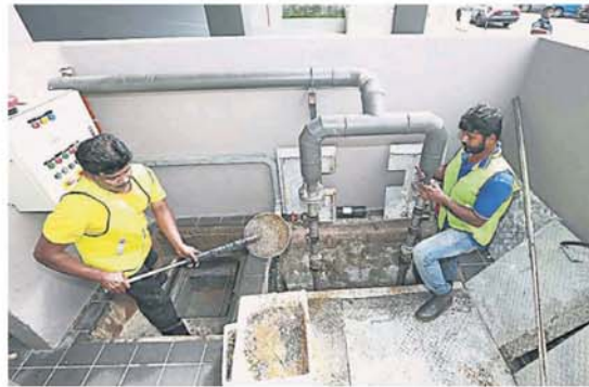
清洁工人必须定时清理污水处理池的固体垃圾，确保污水顺畅排走。
